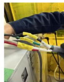
図2. 延長ケーブル接続箇所
