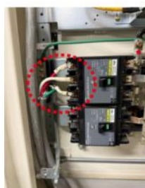
図3. ブレーカ接続箇所
