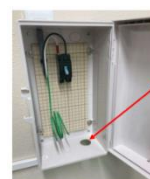
8N211室分電盤 既設ブレーカボックス
