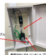
8N211室分電盤 コンセント設置及び電源ケーブルプラグ化
