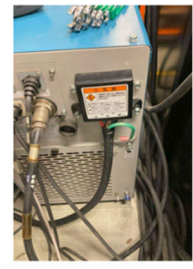
図4.半自動溶接機 電源ケーブル接続部
