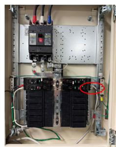
図1.分電盤内(結線箇所赤丸)
