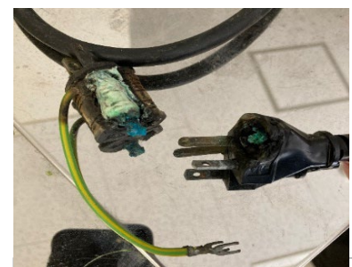
破損箇所（コンセントプラグ）
