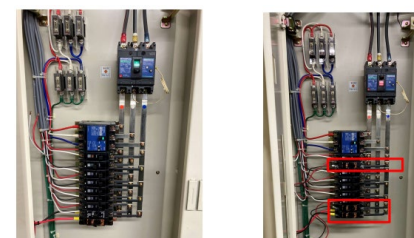
図1.#3111分電盤 改造前
